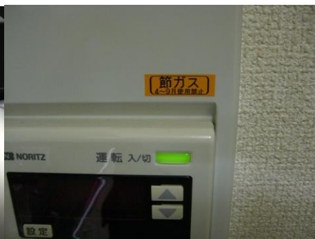
ガス給湯器操作盤への注意表示
